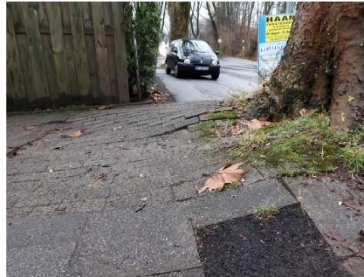
Bild 9: Martin-Luther-Str., extreme Anhebung der Nebenanlage durch Baumwurzeln
