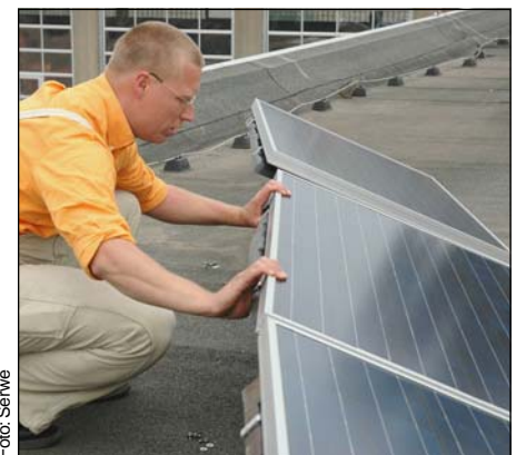
Abb. 8 Die erneuerbaren Energien schaffen Arbeitsplätze in der Industrie und im regionalen Handwerk.
